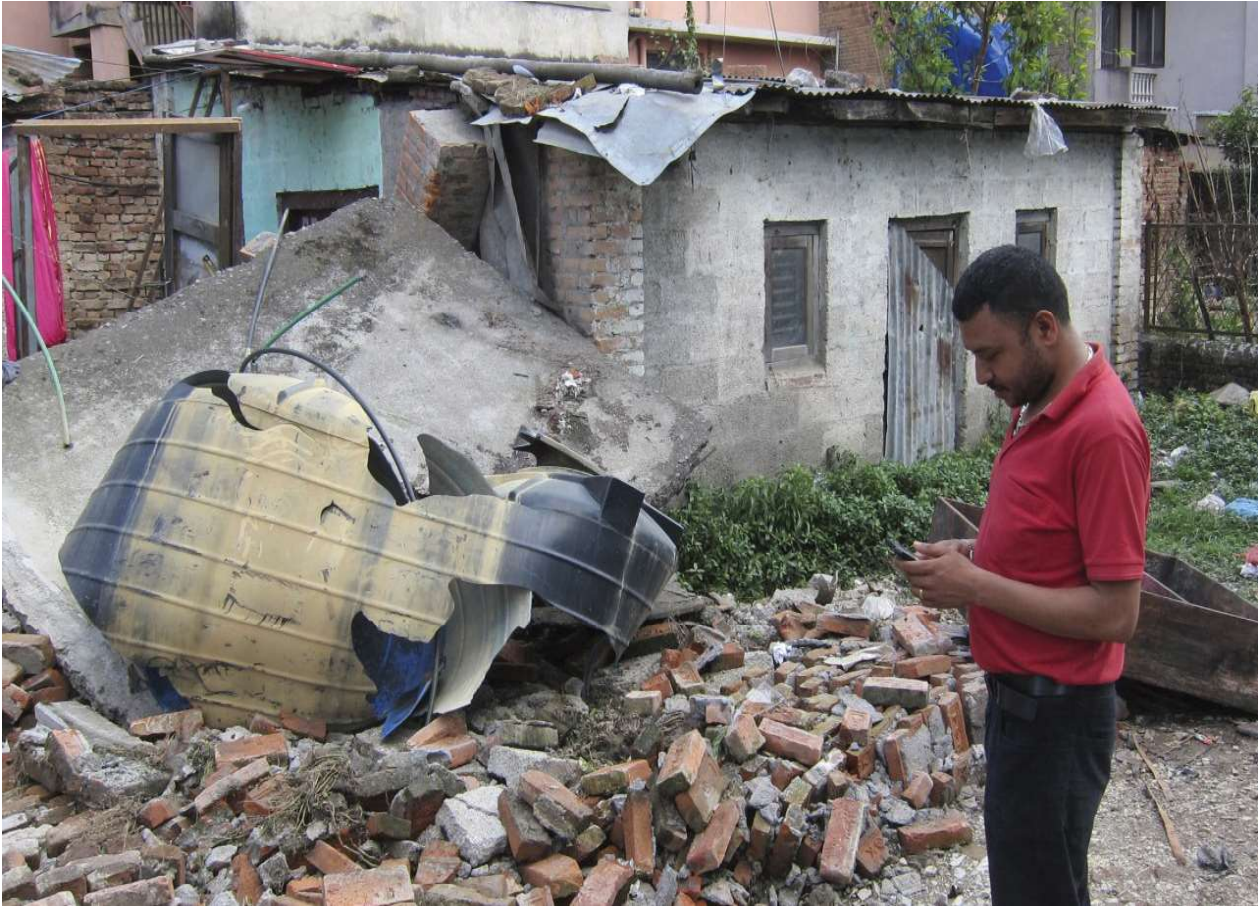
चित्र ३.६५ : भूकम्पबाट क्षतिग्रस्त खानेपानीको ट्याङ्की र पाइप
