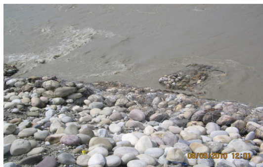
महाकाली नदीको बाढीबाट क्षतिग्रस्त तटबन्ध
