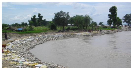
महाकाली नदीको बाढीबाट क्षतिग्रस्त स्पर
