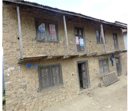
जीर्ण भई छात्रावासको रूपमा प्रयोगमा रहेको गाविस भवन
