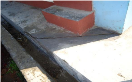
पंचकुले स्वास्थ्य चौकीको नवनिर्मित भवनको चर्किएको चर्किएको पेट्टी
